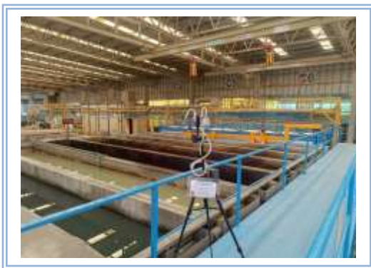
บ่อล้างชิ้นงาน
